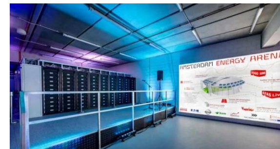
スタジアム内部の大型蓄電池
