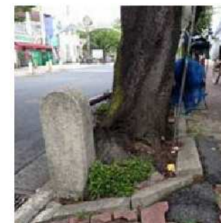
樹木の根上がりで 凸凹になった歩道の舗装
