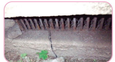
基礎のひび割れを調査
