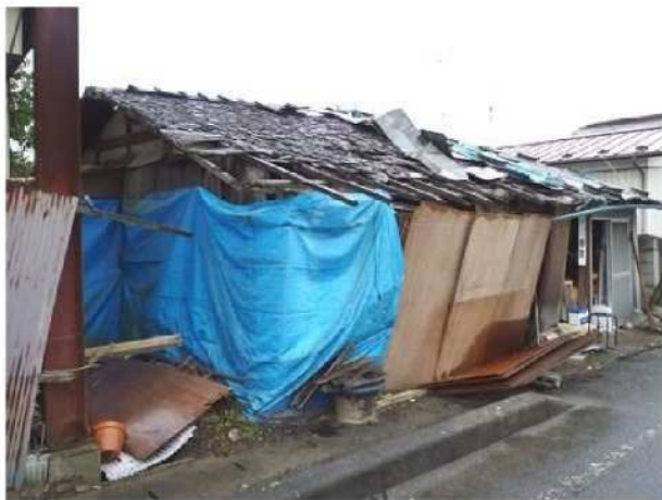
写真18 老朽化した家屋の倒壊
