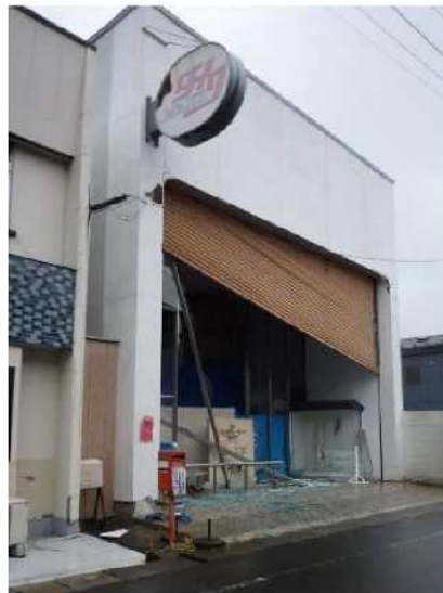
写真23 鉄骨造と見られる建築物の被害
