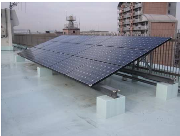
亀有中学校に設置した 太陽光発電システム
