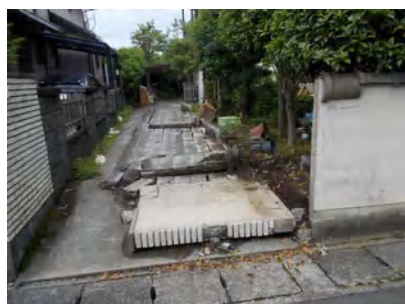
倒壊したブロック塀
