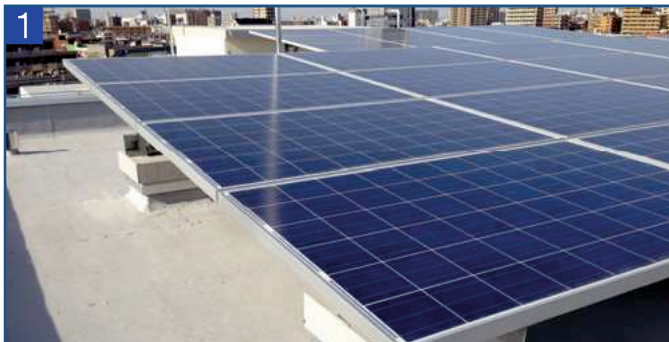
太陽光パネル
