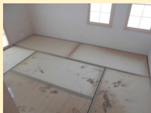
床上浸水の様子
