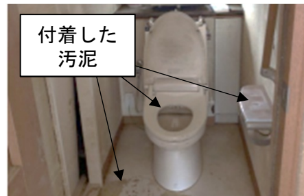
トイレの被災例
