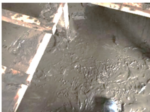
土砂堆積のようす
