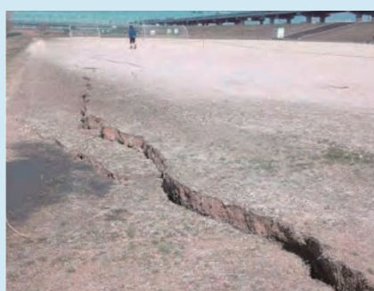
地割れが起こった木根川橋野球場
