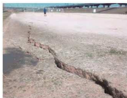
地割れが起こった木根川橋野球場
