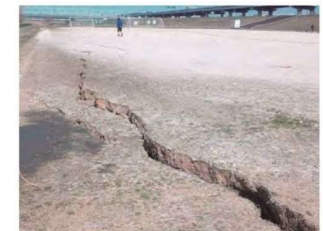
地割れが起こった木根川橋野球場
