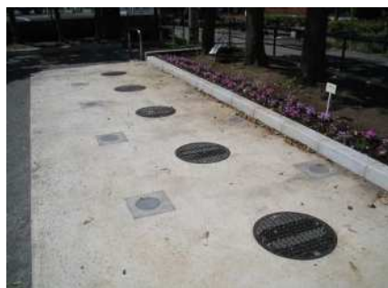
マンホールトイレ
