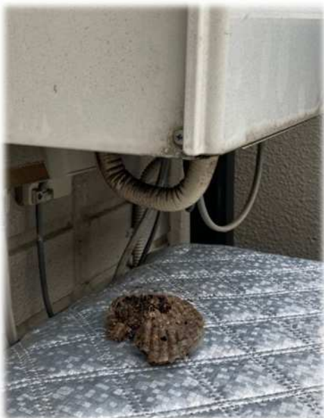
写真⑤ エアコン室外機の上に落ちていたハチの巣
