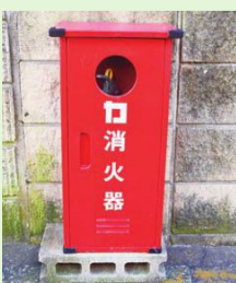
街路消火器格納箱
