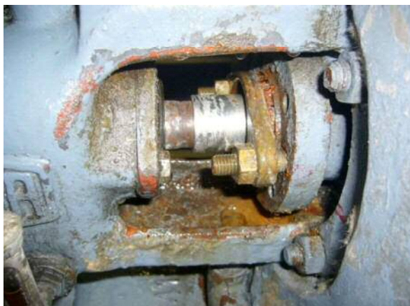
劣化が顕著にみられる、冷温水ポンプ
