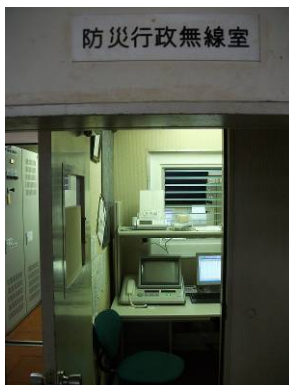
狭い防災無線室
