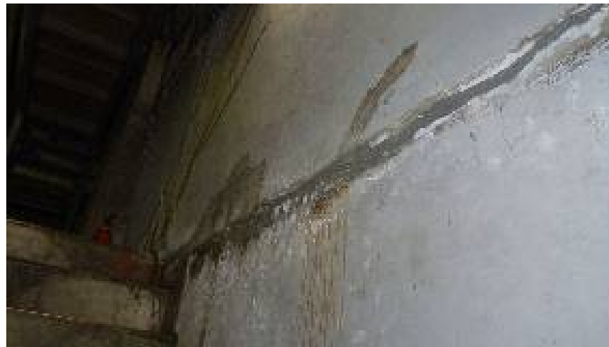
壁のひび割れ(クラック)
