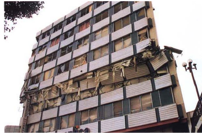
中層階が崩れたビル
