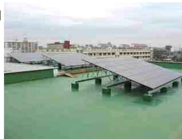
▲ 区役所総合庁舎屋上に設置された太陽光パネル
