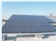
太陽光パネル
